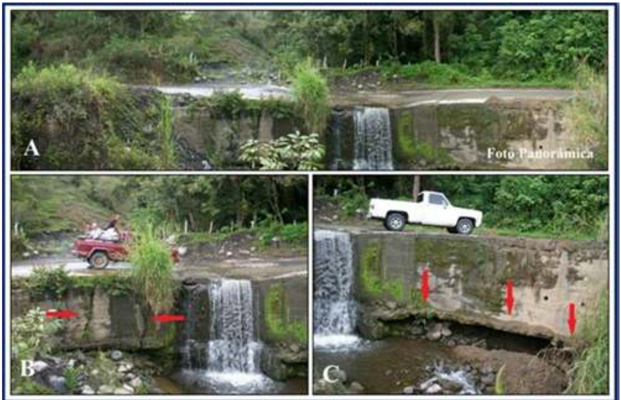
Figura 4. Foto panorámica de la carretera (batea de agua), progresiva 1+511. B. Carretera con fisuras en su estructura de concreto. C. Socavamiento en la base de la carretera. Progresiva 1+511 Tramo Jaji.
