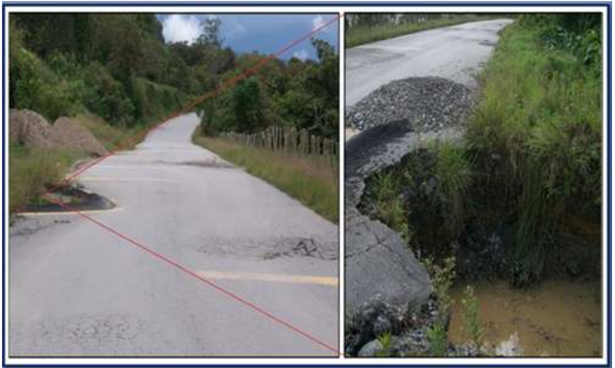
Figura 3. Carretera con defectos superficiales y de fundación y colapso lateral; progresiva 0+733 tramo la Azulita.
